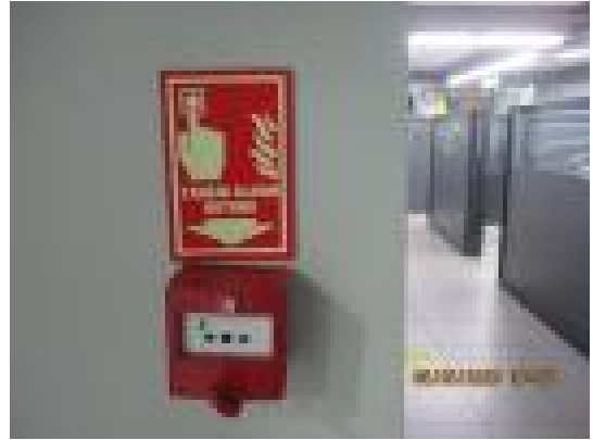
Fire alarm button.JPG
