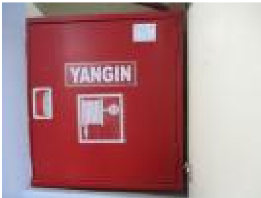
Fire hose cabinet.JPG
